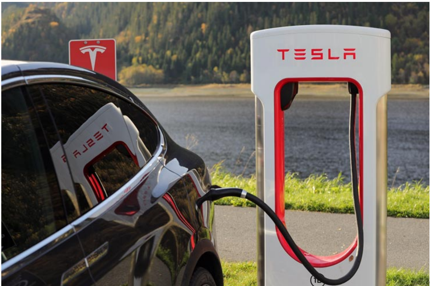
Ladestation für Elektroautos in Norwegen ( Foto Blomst )
